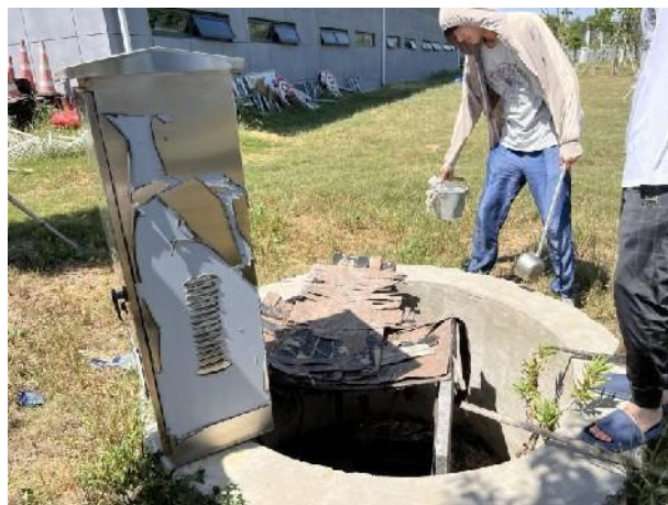
收费站化粪池
