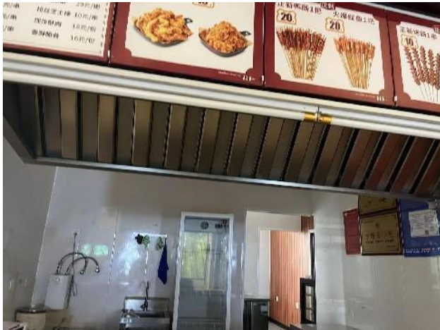
收费站东区油烟净化装置
