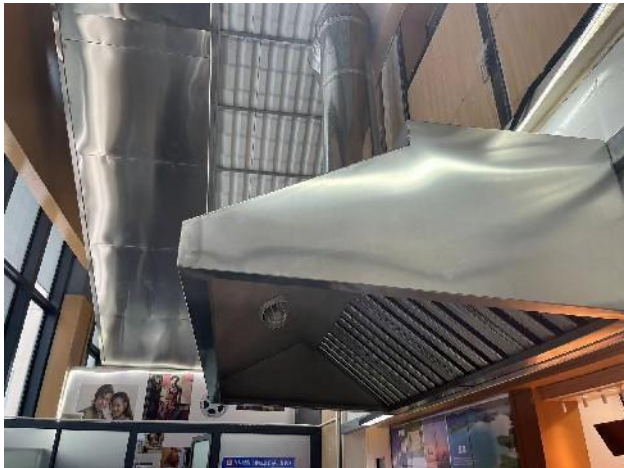
收费站西区油烟净化装置
