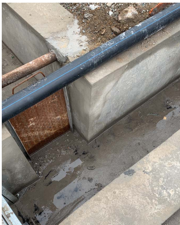
图 4-2 现有雨水明渠及雨水切换阀
