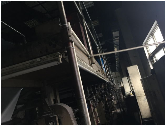
废气收集管道
