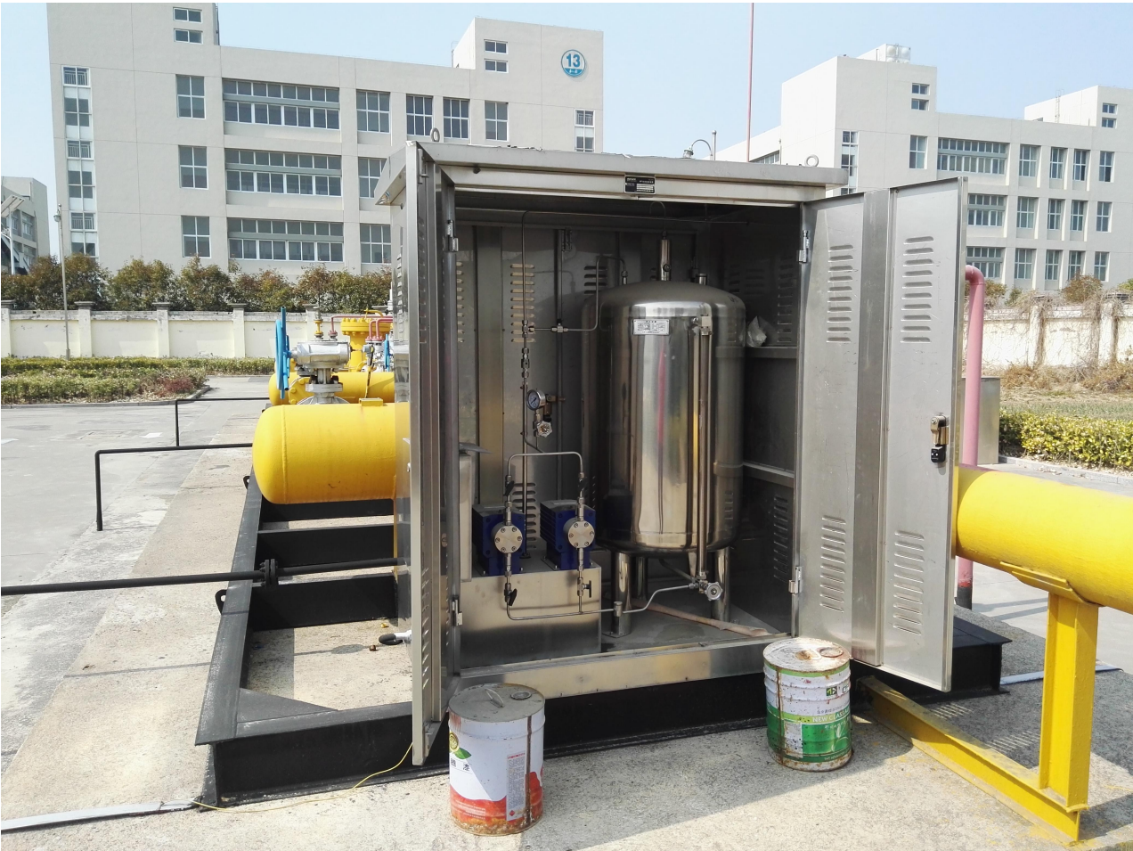
图 3.3-2 加臭剂四氢噻吩储存情况
