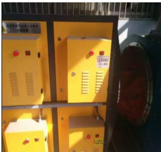
A 车间废气处理设备
