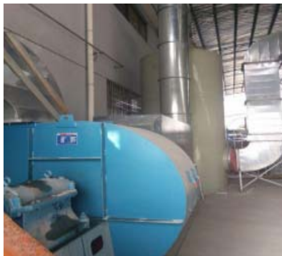
B 车间废气处理设备
