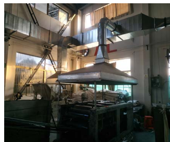
印刷废气收集系统
