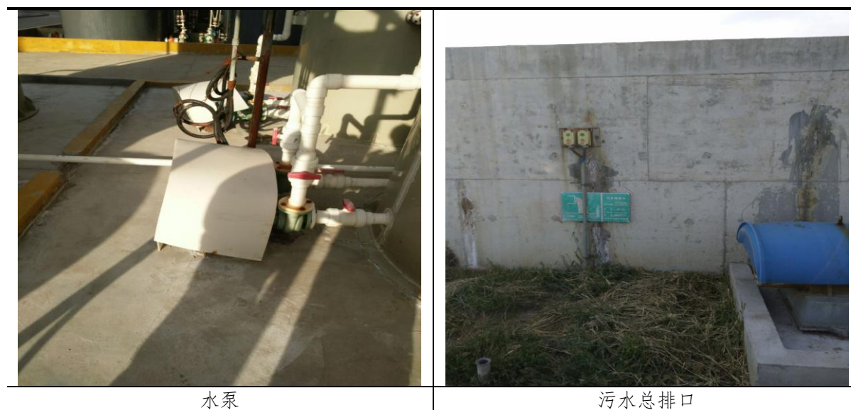
图 4-2 废水治理设施图
