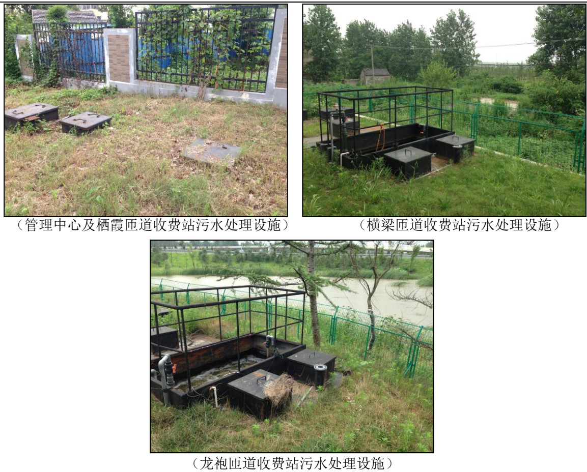
图 8.3-1 公路沿线设施污水处理设施装置现场照片
