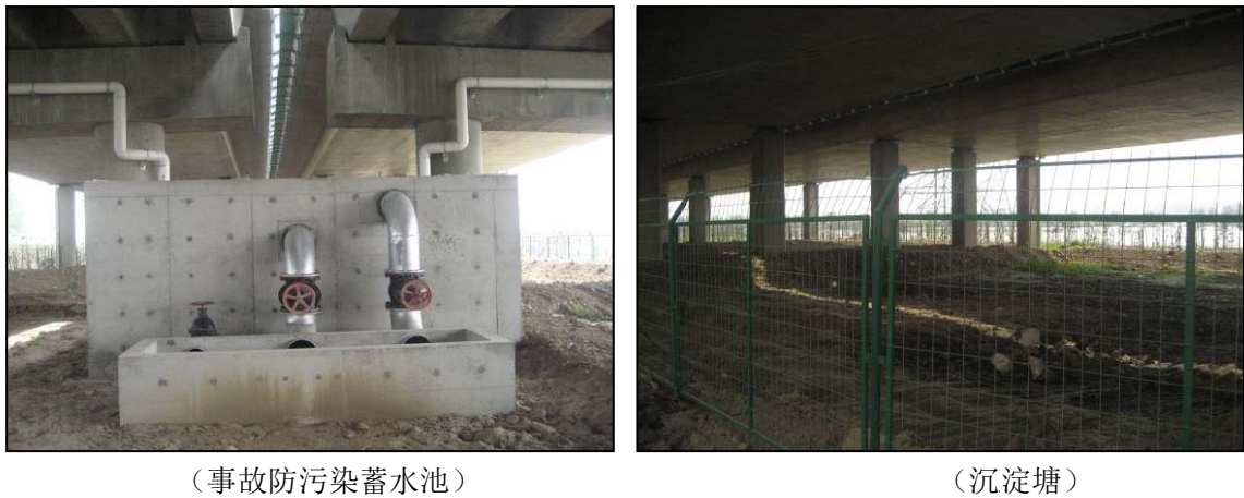
图 9.4-3 九乡河桥面径流收集系统现场照片
