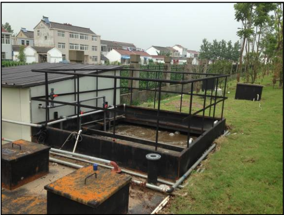
（主线收费站污水处理设施）
