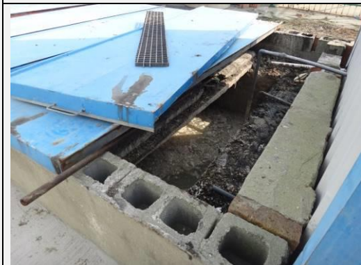
图 5 食堂废水隔油池
