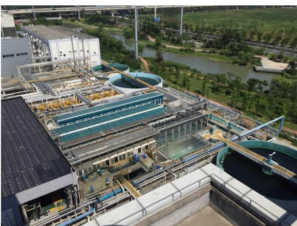
废水处理设施
