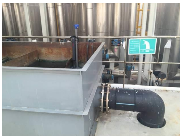
废水总排口（接管口）
