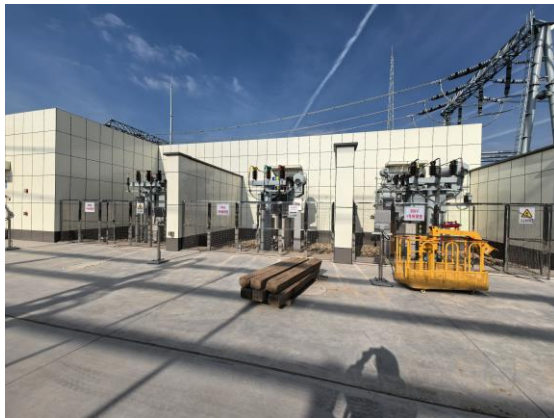
站用变防火墙
