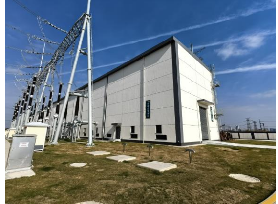
500kV 户内 GIS 室
