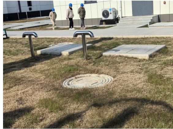
电抗器事故油池
