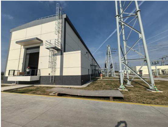
220kV 户内 GIS 室
