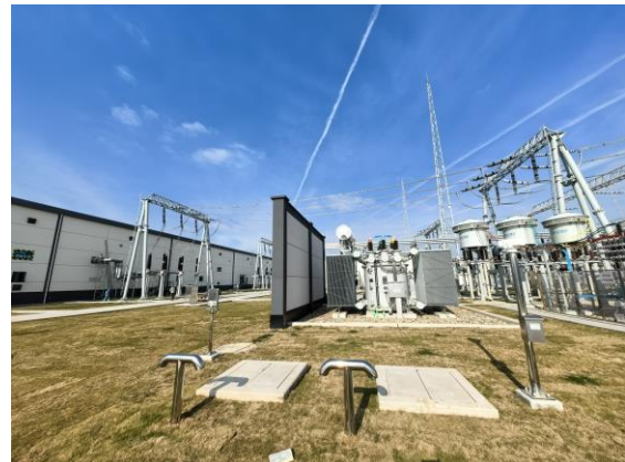
站用变事故油池
