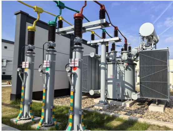
电抗器防火墙
