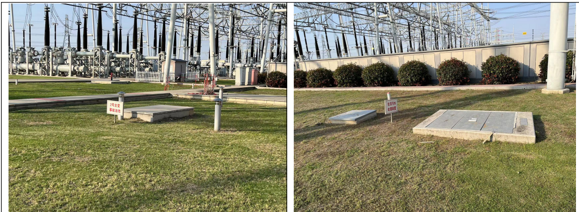
#3 事故油池 (#2 主变事故油池)
