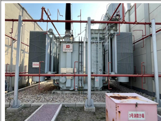
#2 主变区及主变油坑、防火防爆墙
