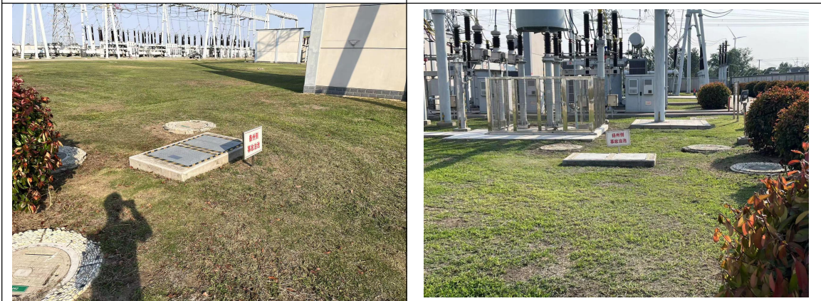
#1 事故油池 (泰州侧事故油池)
