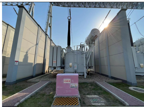
#3 主变区及主变油坑、防火防爆墙
