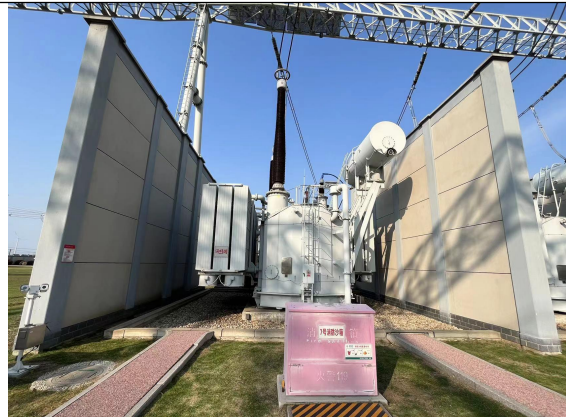
#5 主变区及主变油坑、防火防爆墙
