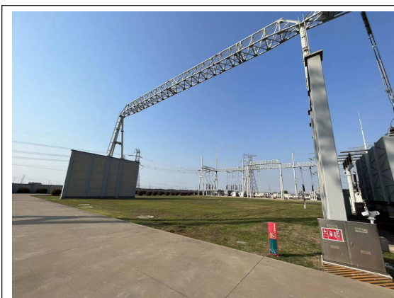
本期扩建#6 主变区及已有防火防爆墙
