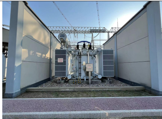
#5 主变低抗油坑及防火防爆墙
