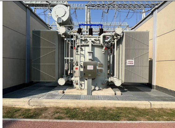
#2 主变低抗油坑及防火防爆墙
