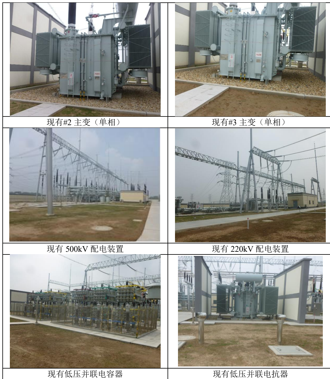
图 3.1-2 滨响 500kV 变电站现有装置照片
