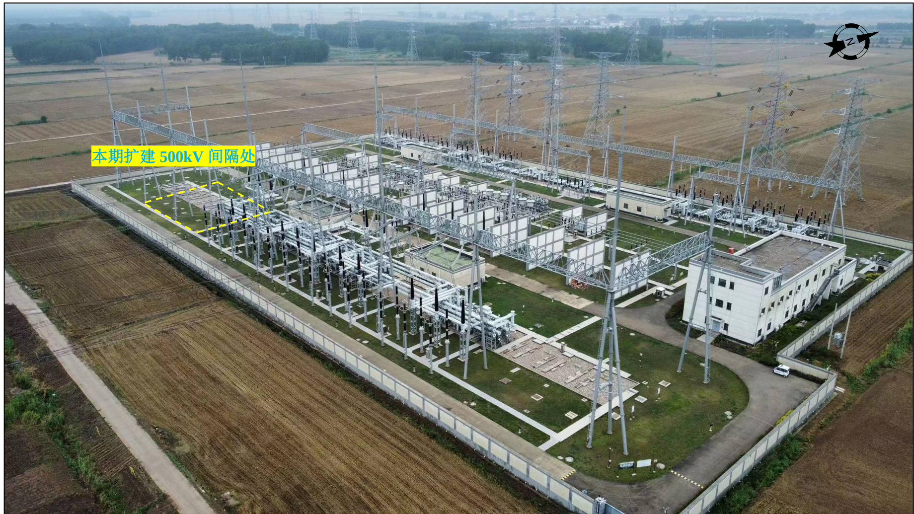
图 3.1-1 滨响 500kV 变电站现有整体照片
