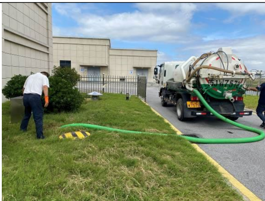
图 4.2-1 污水处理设施及污水清运过程
