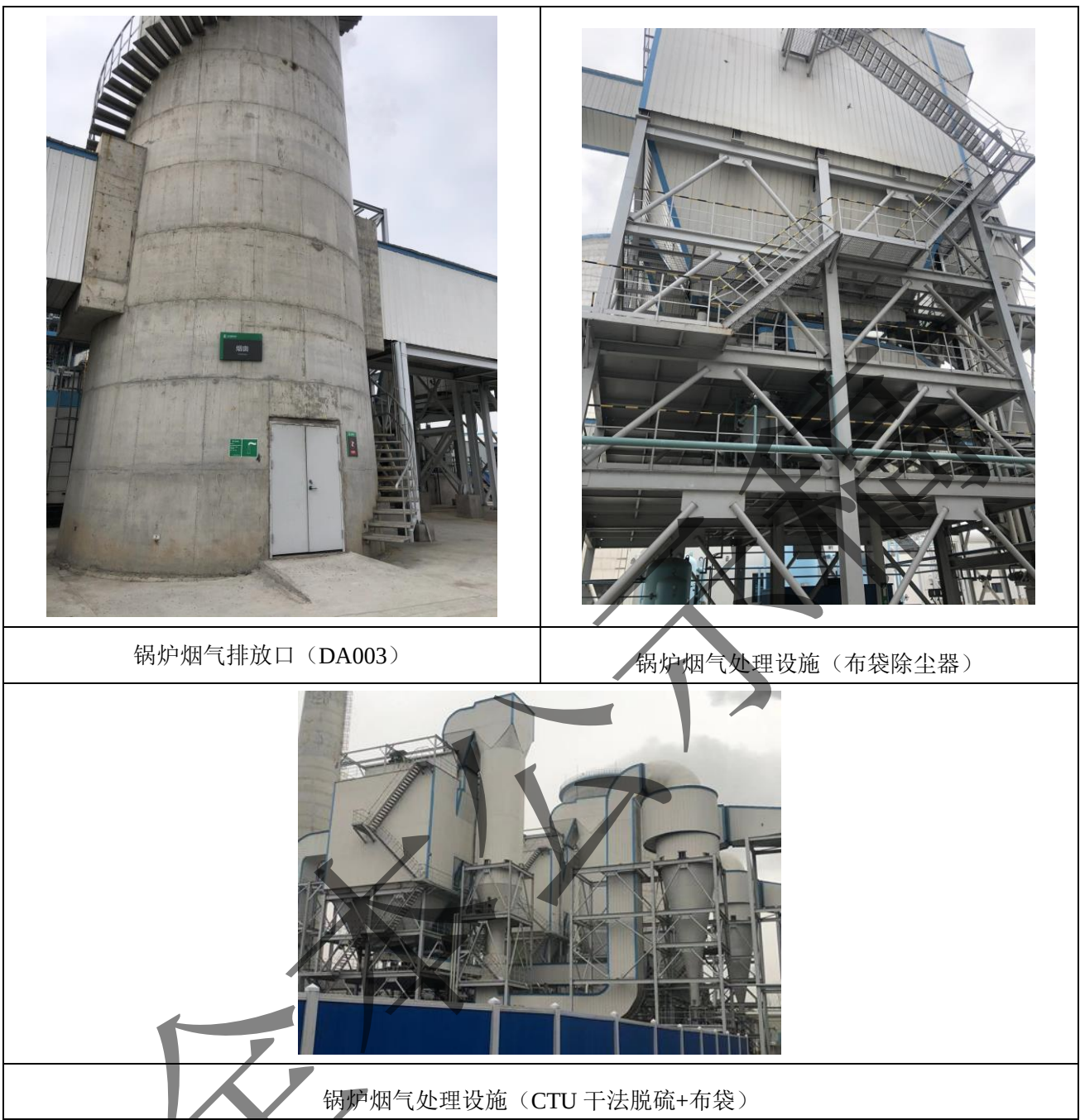
图 3.5-2 现有项目部分废气处理设施现场照片
