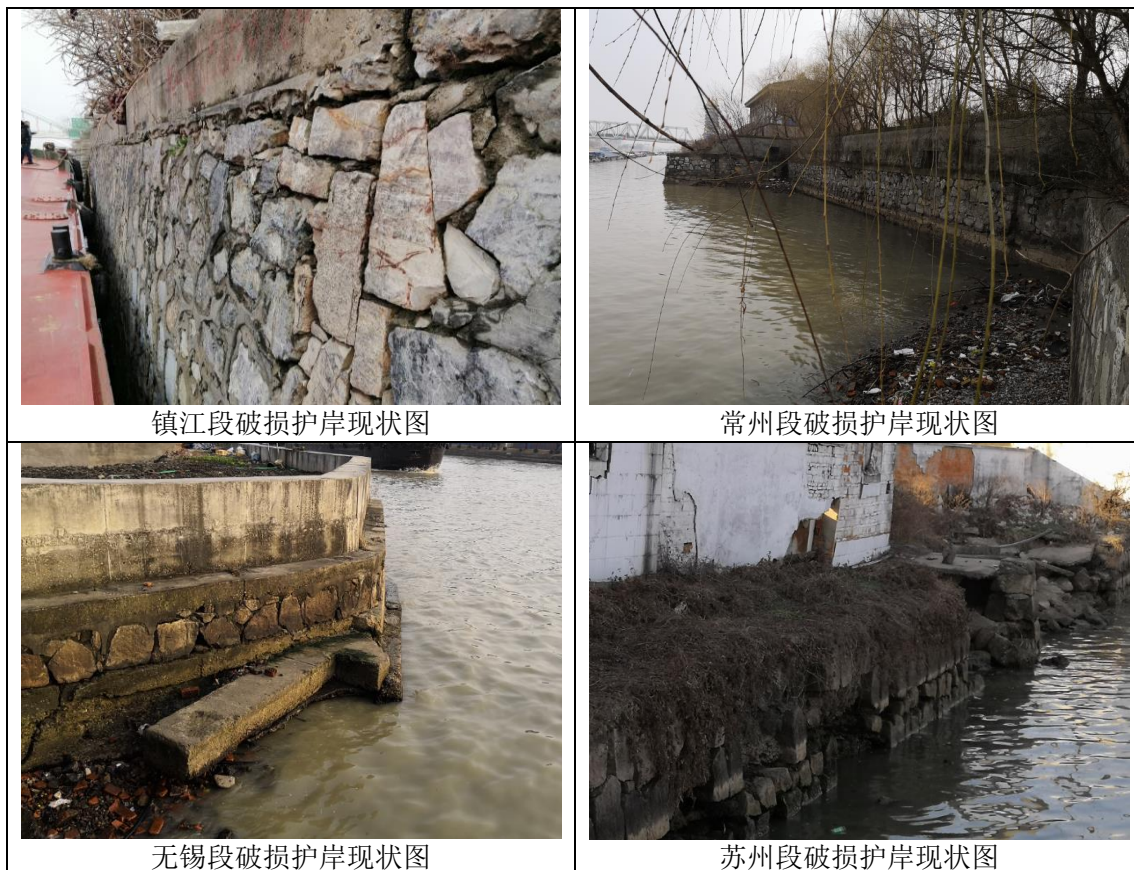
图 2.1-1 京杭运河（江南段）破损护岸现状图
