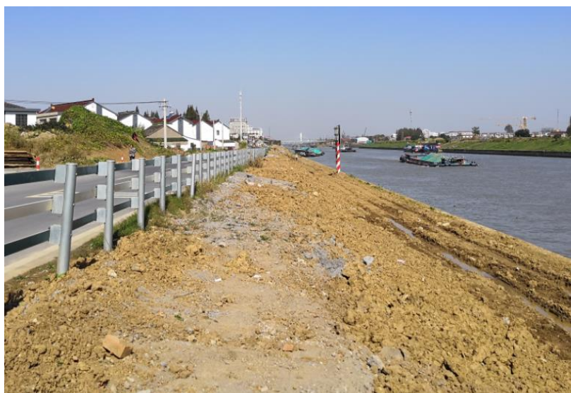
图 2.1-10 京杭运河江南乡村段绿化缺损段现状图（镇江）
