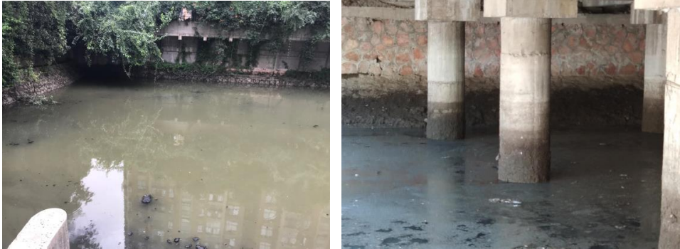
图5 进水渠淤积现状图
