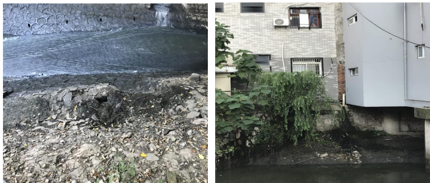
图6 河道驳岸局部破损示意图
