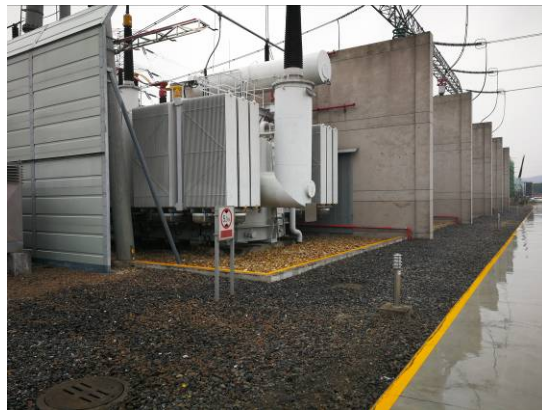
1#、2#主变压器西侧情况
