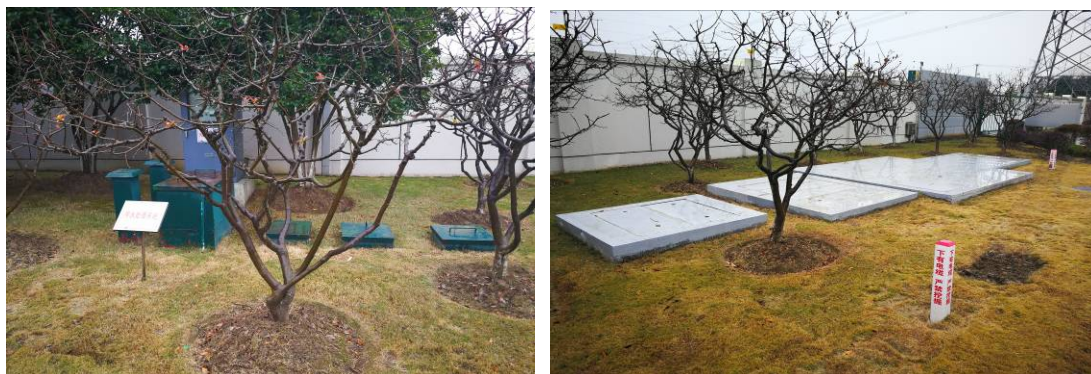
图 3.4 木渎 500kV 变电站地埋式污水处理装置和排水泵站
