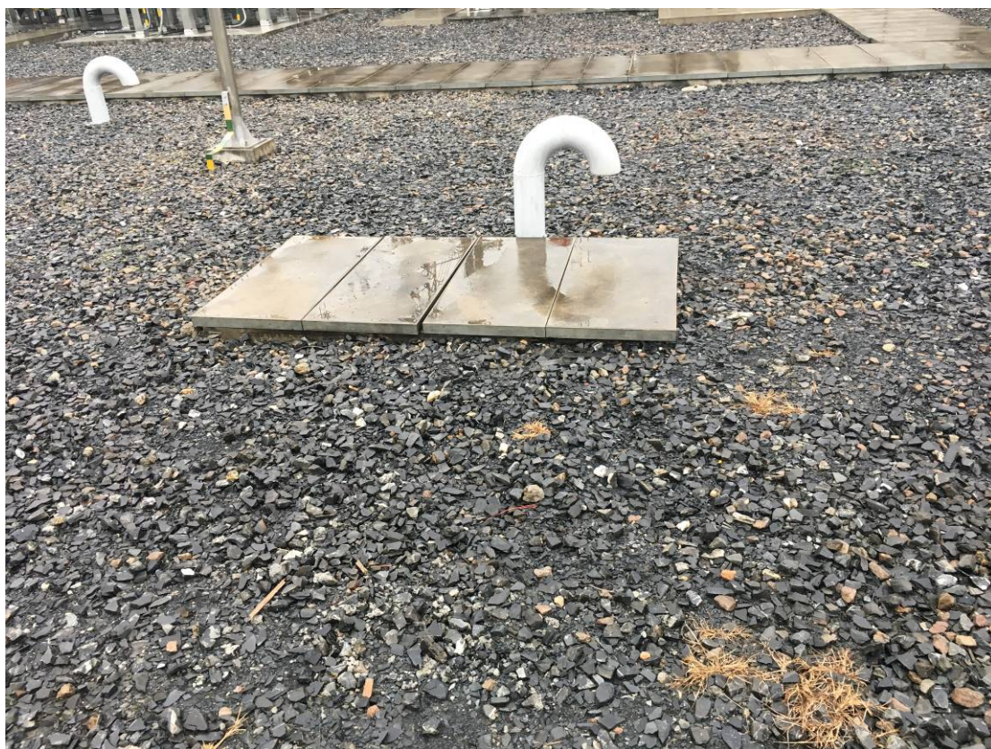
图 3.5 木渎 500kV 变电站事故油池
