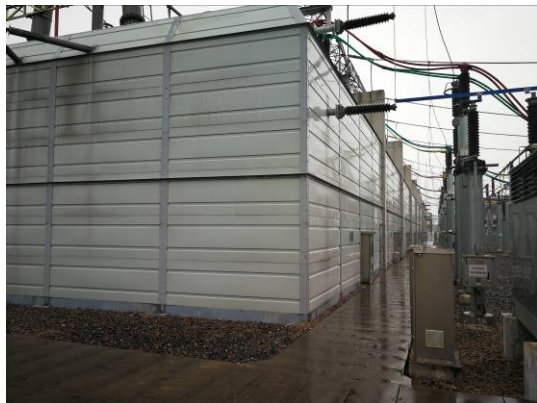
1#、2#主变压器西侧、南侧的隔音板
