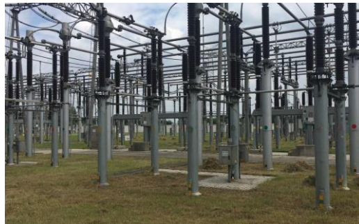
现有220kV配电装置区
