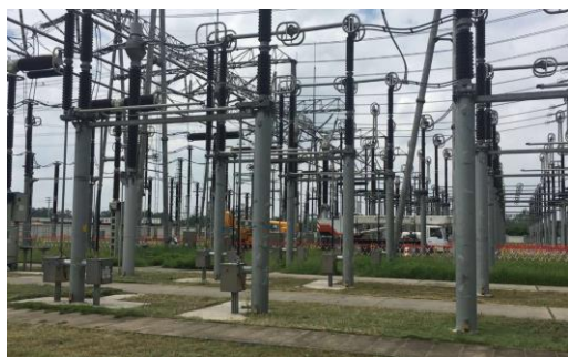
现有500kV配电装置区
