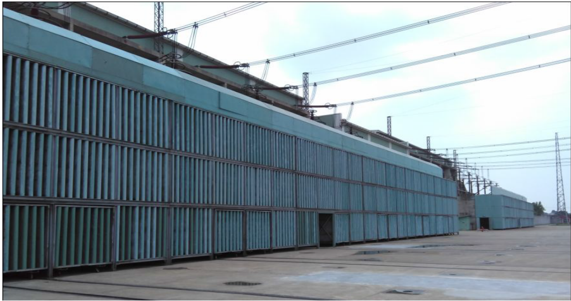
图 3.3 换流变压器噪声治理措施
