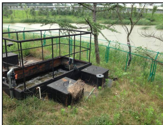
（龙袍匝道收费站污水处理设施）
