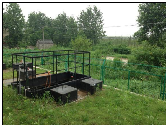
（横梁匝道收费站污水处理设施）
