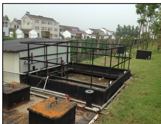
(主线收费站污水处理设施)
