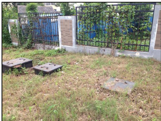
（管理中心及栖霞匝道收费站污水处理设施）
