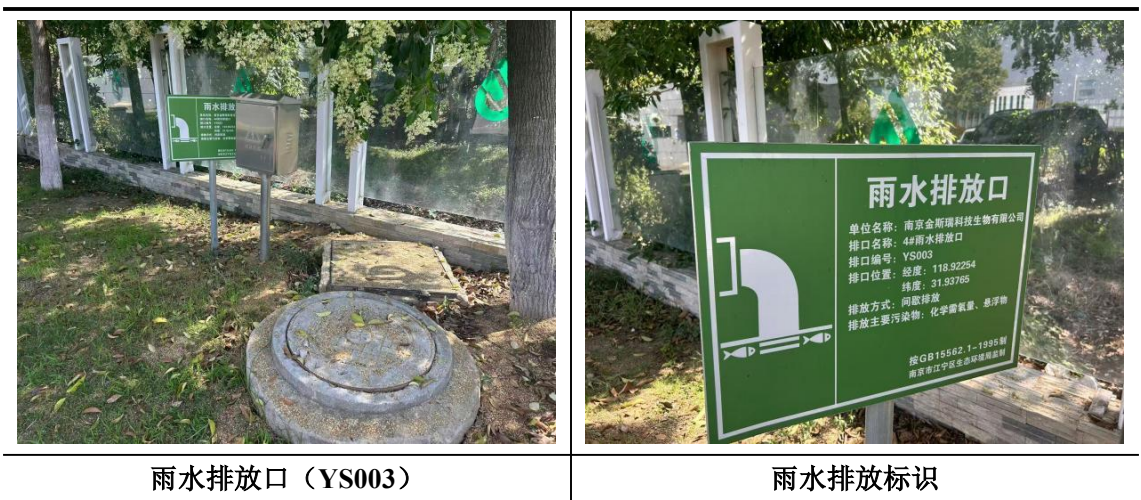
图 3.5-6 废水处理及雨水排口设施
