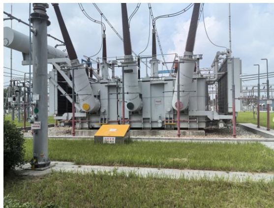
主变及事故油坑
