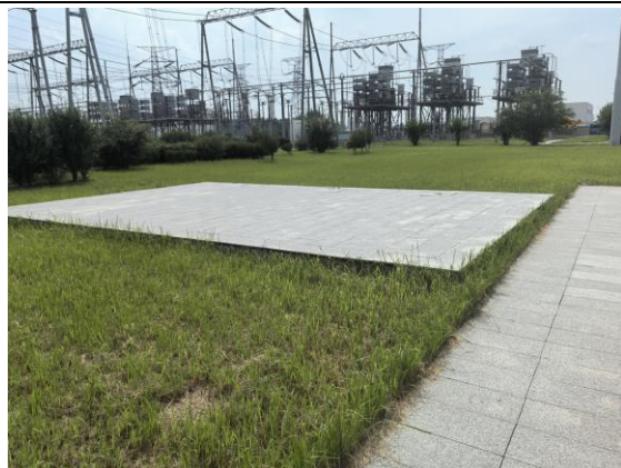
主变、电抗及站用变事故油池
