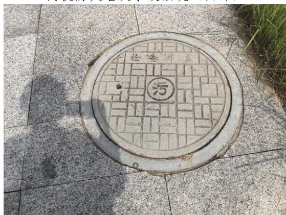
站内雨污分流污水井
