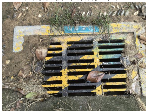
站内雨污分流雨水井
