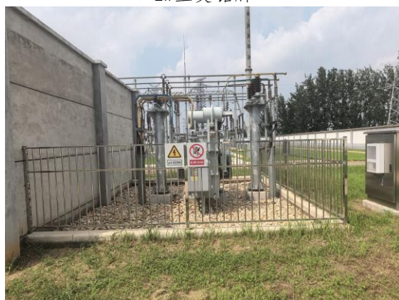
站用变事故油坑及防火墙
