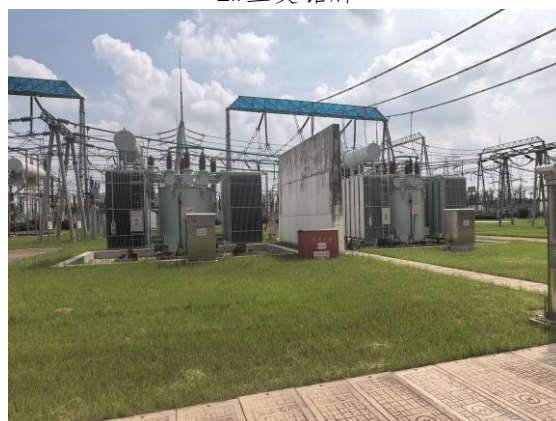
低压电抗器油坑级防火墙
