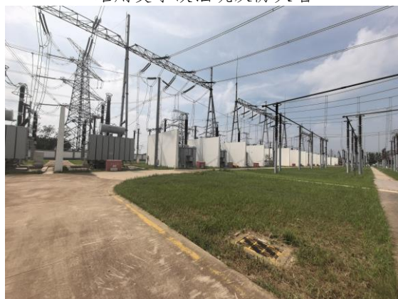
高抗防火墙及事故油坑（西部）
