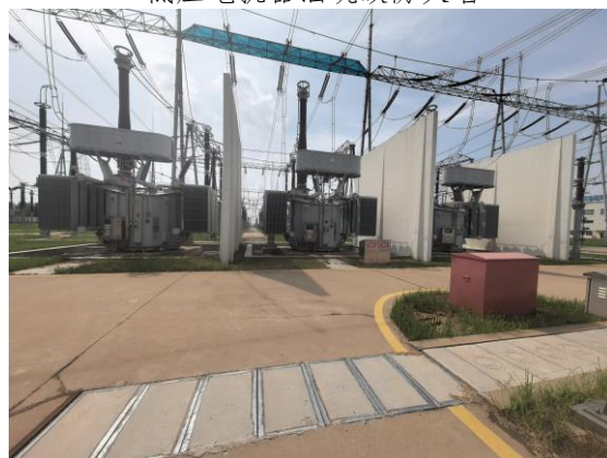
高抗防火墙及事故油坑（东部）
