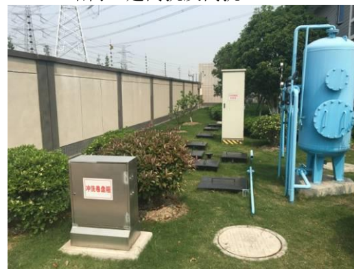
污水处理装置
