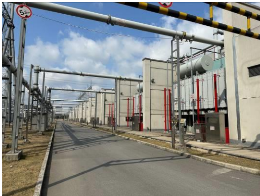
站内已建主变及主变防火墙
