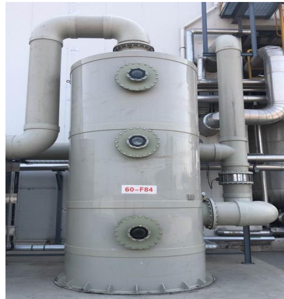
AKD 及松香线填料除雾塔
