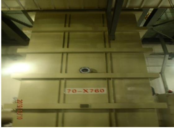
10、20、30、40 线共用填料除雾器现状图
