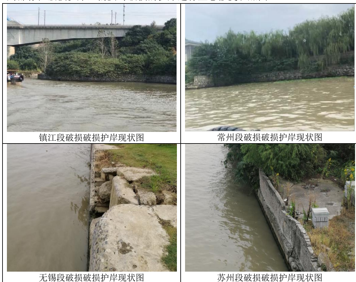
图 2.1-1 京杭运河（江南段）破损护岸现状图
