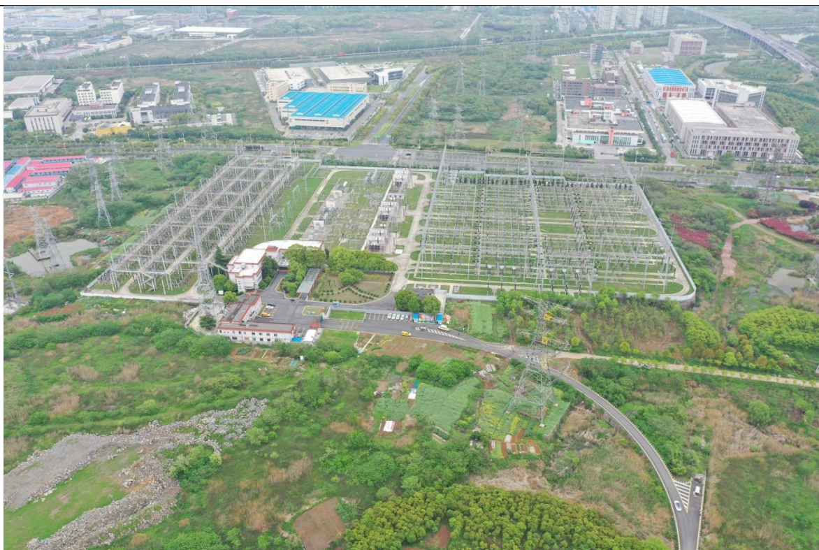
图 3.1-4 原有东善桥 500kV 变电站
