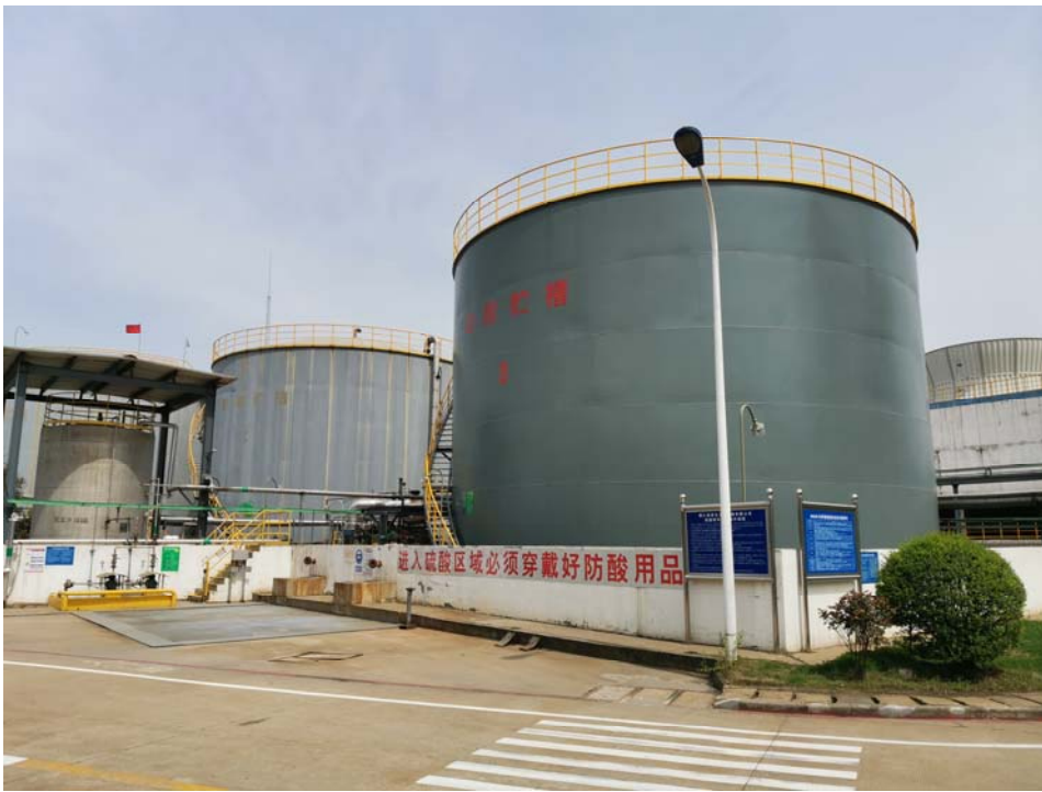
图 3.2-2 硫酸罐区现场照片
