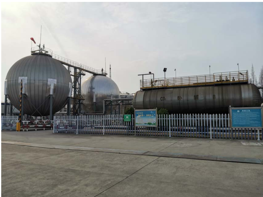
图 3.2-1 二氧化碳罐区现场照片
