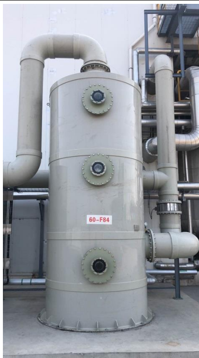
AKD 及松香线填料除雾塔
