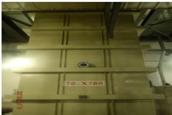
10、20、30、40 线共用填料除雾器现状图
